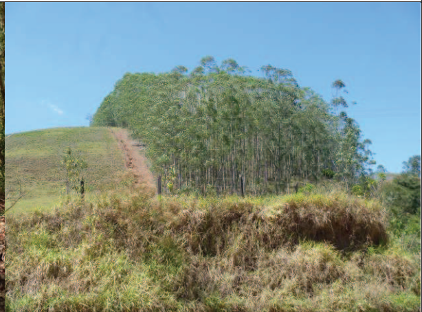
Aceiro em plantio florestal com presença de processo erosivos
