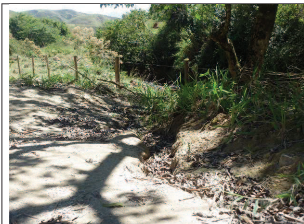
Corte de água impróprio, condução direto para o rio
